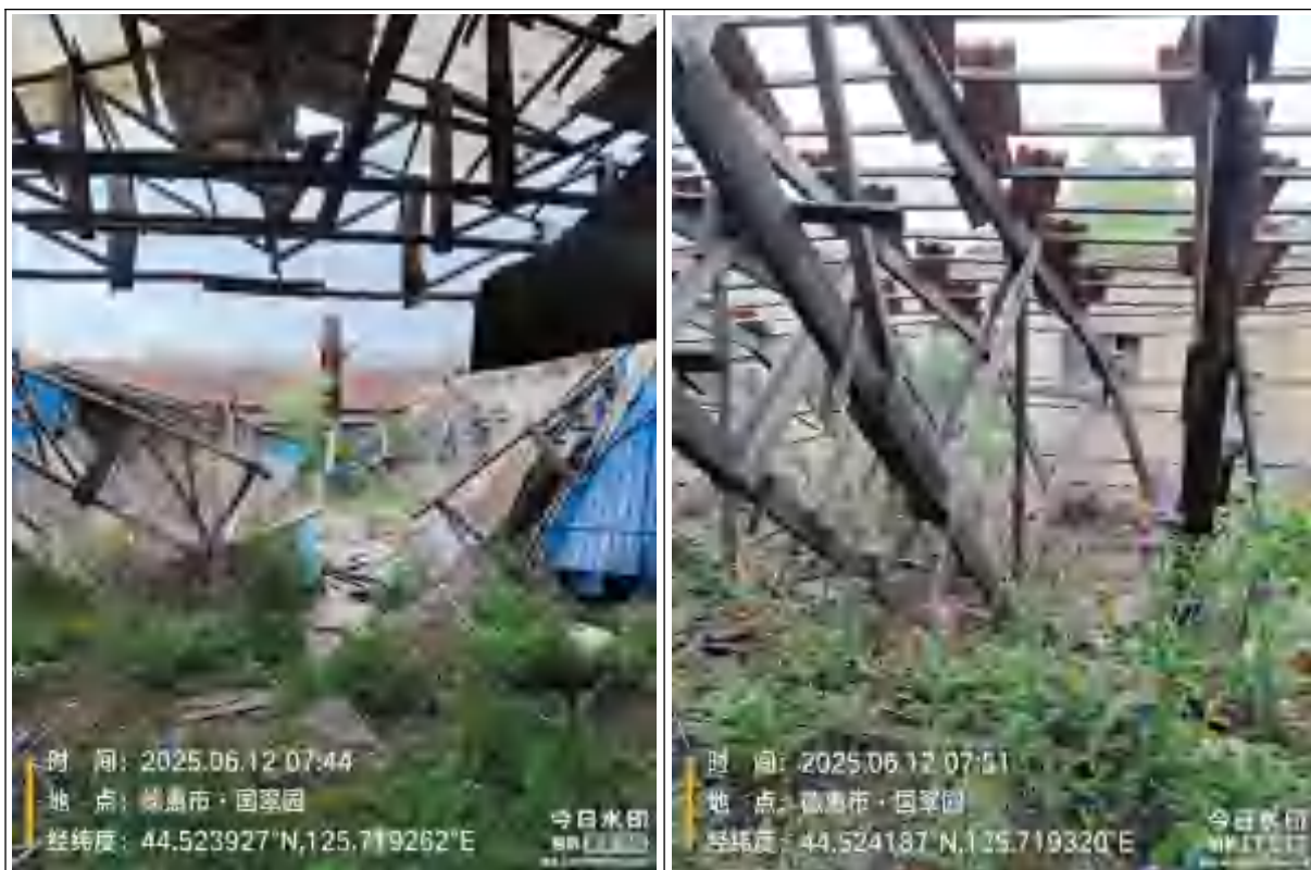
宗久农机厂部分坍塌房屋
